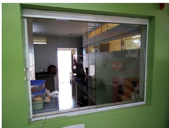
ausência de tela milimetrada na janela da cozinha
