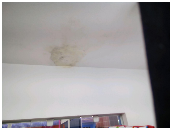
Mofo no teto do berçário
